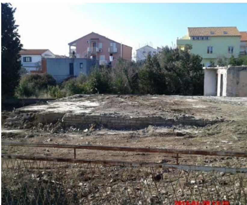
Slika 10. Izvršenje putem trećih osoba na lokaciji
