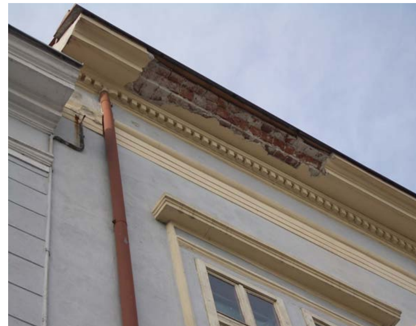
Slika 7. Prikaz oštećenja pokrova
