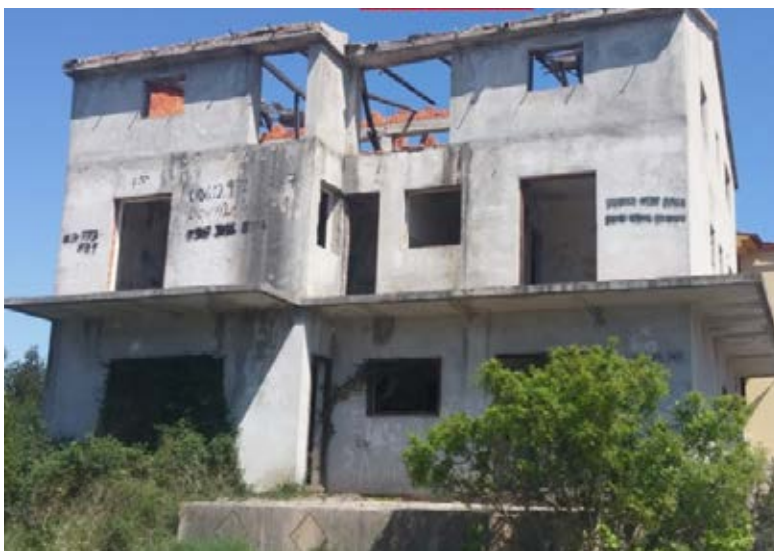
Slika 9. Prikaz oštećenja pročelja i pokrova
