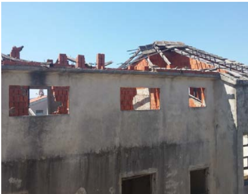
Slika 8. Prikaz oštećenja pokrova
