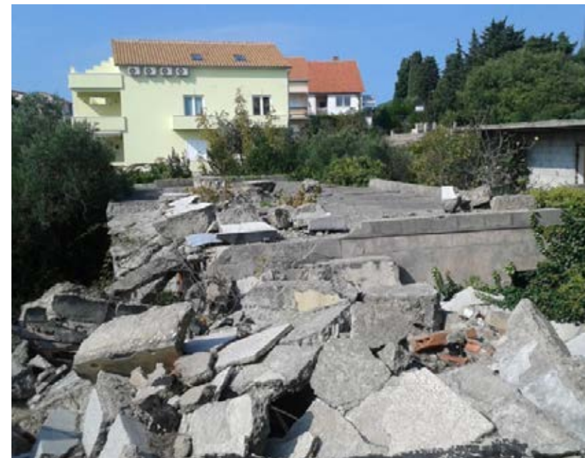
Slika 3. Prikaz ruševine zgrade
