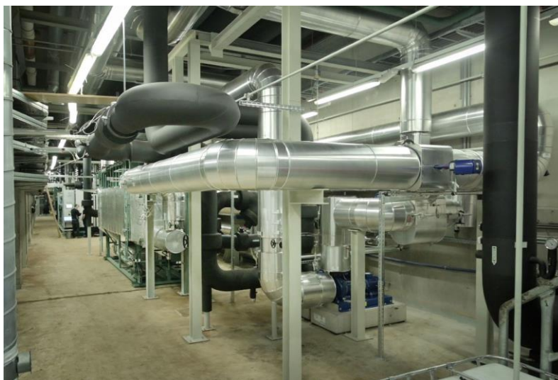
Centrala za daljinsko hlađenje na bečkom Glavnom kolodvoru © Johannes Zinner Wien Energie
